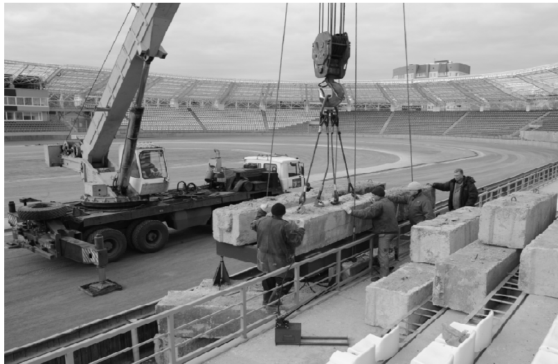
Рис. 4.3. Установка блоков на грузовую площадку для усилия P_1 и пригруза опорной балки трибуны под усилие P_2 (сиденья с трибун демонтированы)
